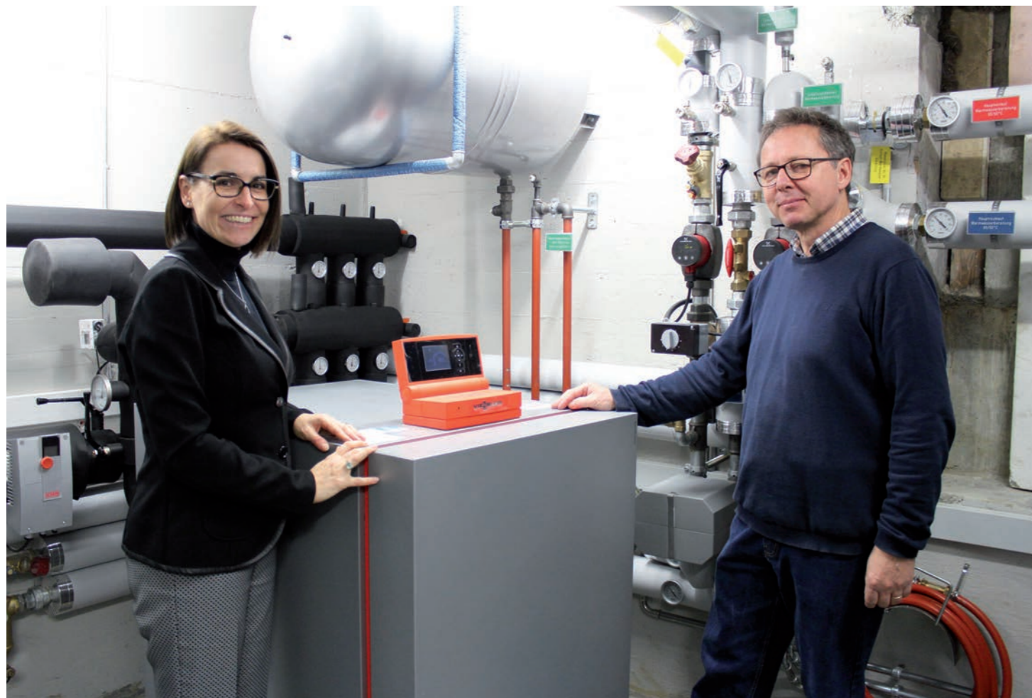
Cornelia Omlin und Architekt Beat Fischer vor der Heizung, die mit Sonnenenergie und Erdwärme betrieben wird.
