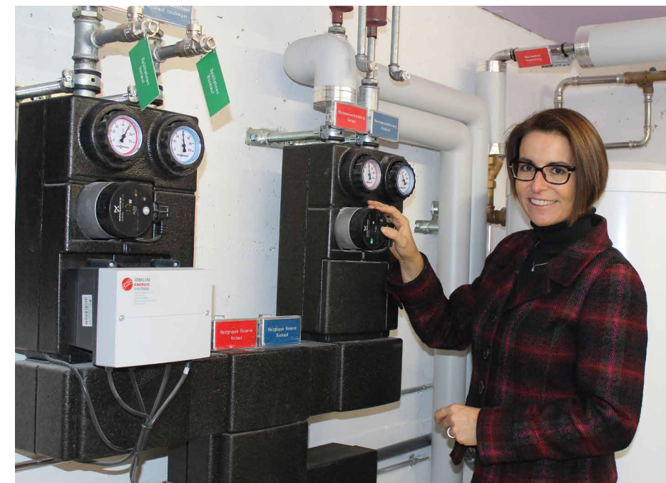
Cornelia Omlin kontrolliert persönlich die Effizienz der neuen Heizungsanlage.
