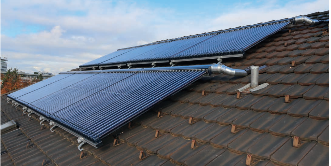
Die modernen Röhrenkollektoren sind ein Musterbeispiel für eine wirklich effiziente Nutzung der Sonnenenergie.
