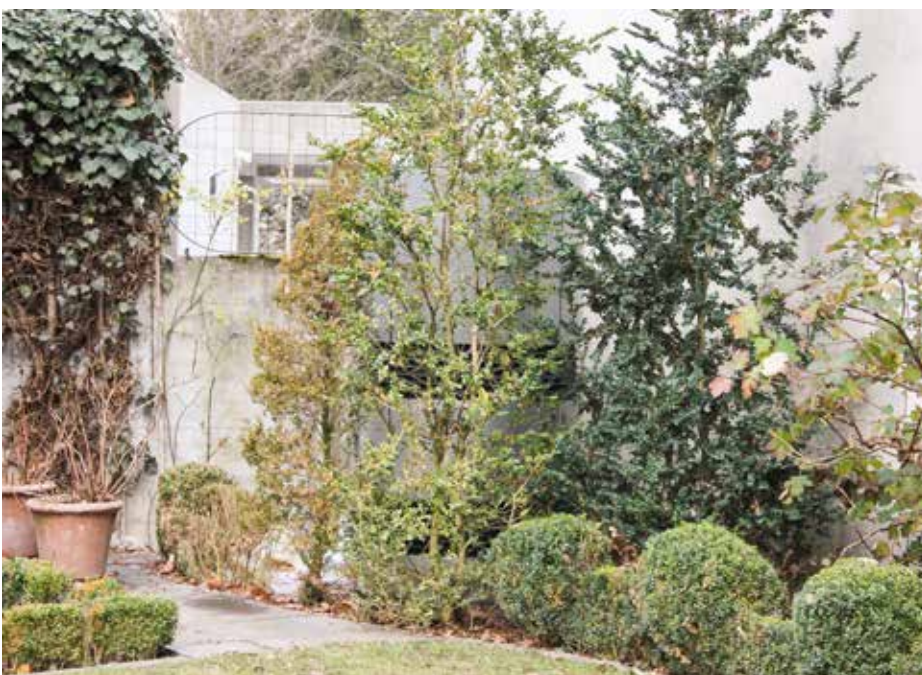
Wenn genug Platz da ist, lässt sich eine Wärmepumpe manchmal hinter Sträuchern verstecken.
